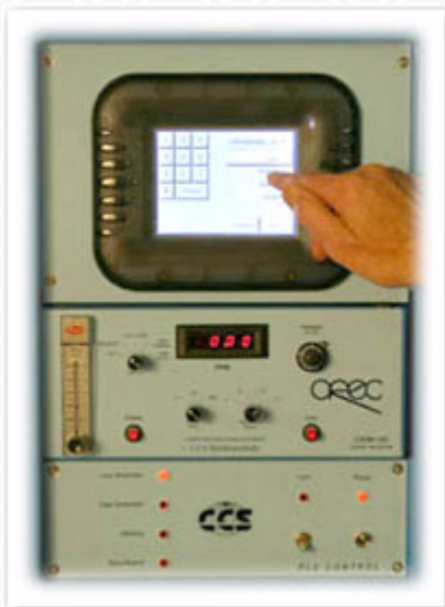
Sistema de Control
